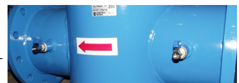
Fig.4 Toma de Manómetros
